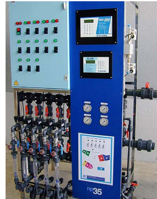
Equipo de fertirrigación automática
